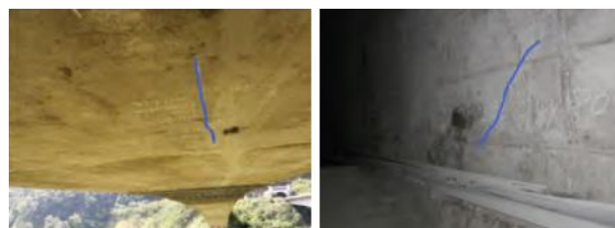
图 1 预应力混凝土连续梁桥的梁体裂缝病害的实拍图
